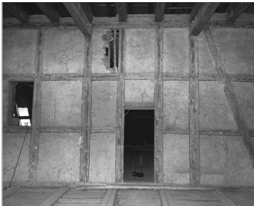
fot. 5. Siemczyno – pałac, ryglowa ściana w obrębie poddasza, fot. W. Witek, 2018
