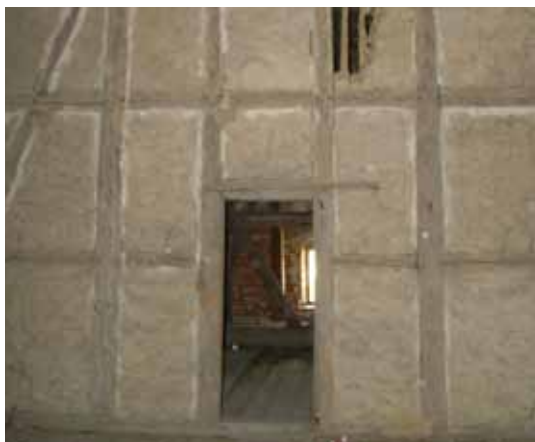
Ryglowa ściana na poddaszu pałacu w Siemczynie, gm. Czaplinek, fot. W. Witek, 2012
