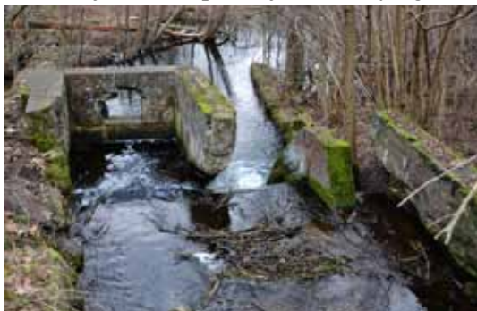
Ruina po gnieździe turbiny i generatora w młynie w Głębokiem.
