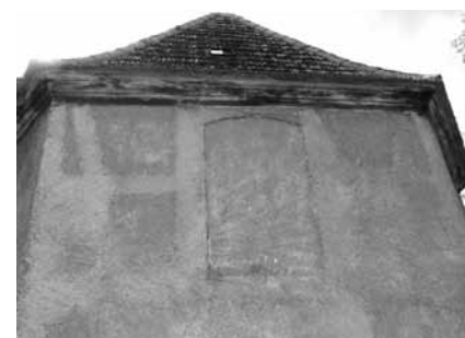
Wtórnie otynkowane elewacje tynkiem cementowym, spod którego uwidacznia się konstrukcja szkieletowa; Dołgie, gm. Ostrowice, kościół; fot. Aleksandra Hamberg-Federowicz 2013
