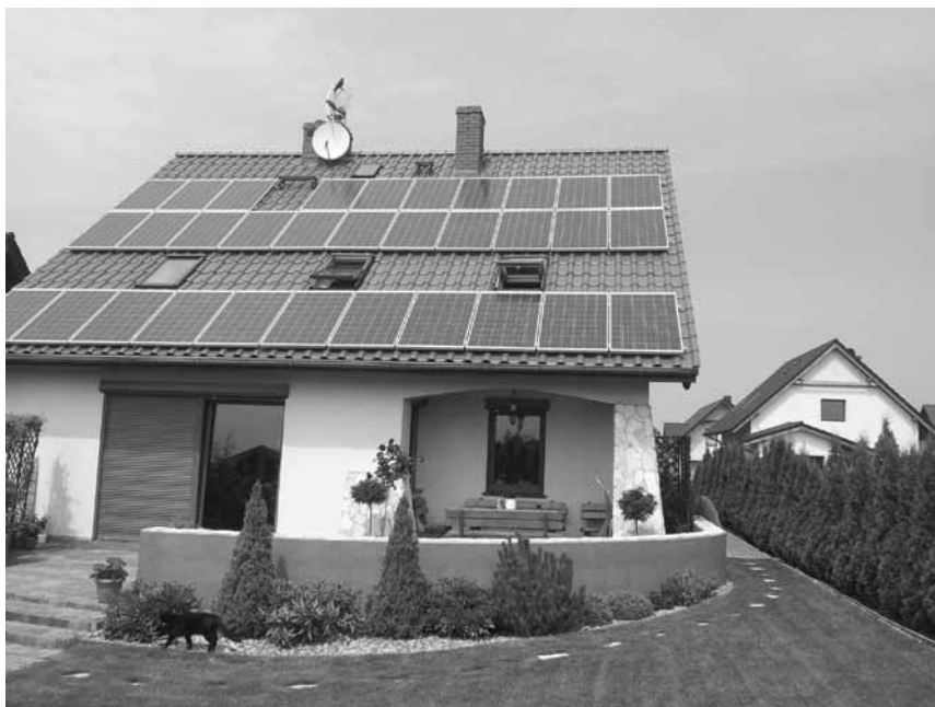
rys. 2 Mikroelektrownia fotowoltaiczna o mocy 8kW zrealizowana w Dobrej Szczecińskiej. (Fot A. Mickiewicz).
