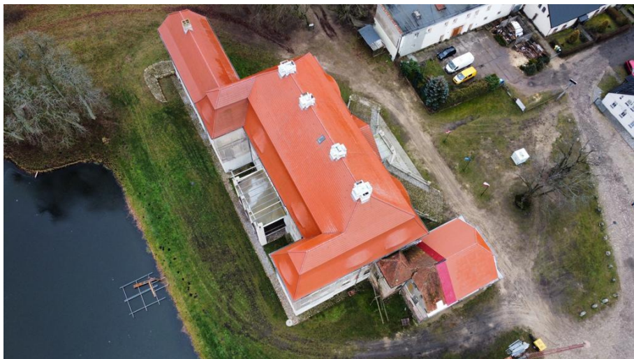
Rys. 4. Dach pałacu - stan na luty 2023 – brakuje tylko remontu części dachu skrzydła północnego.
