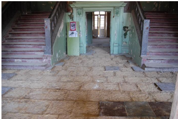
Rys. 13. Hol pałacu po kradzieży marmurowej posadzki w 2011 roku.
