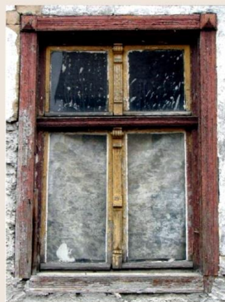
Mieszkowice, okno niezachowane
