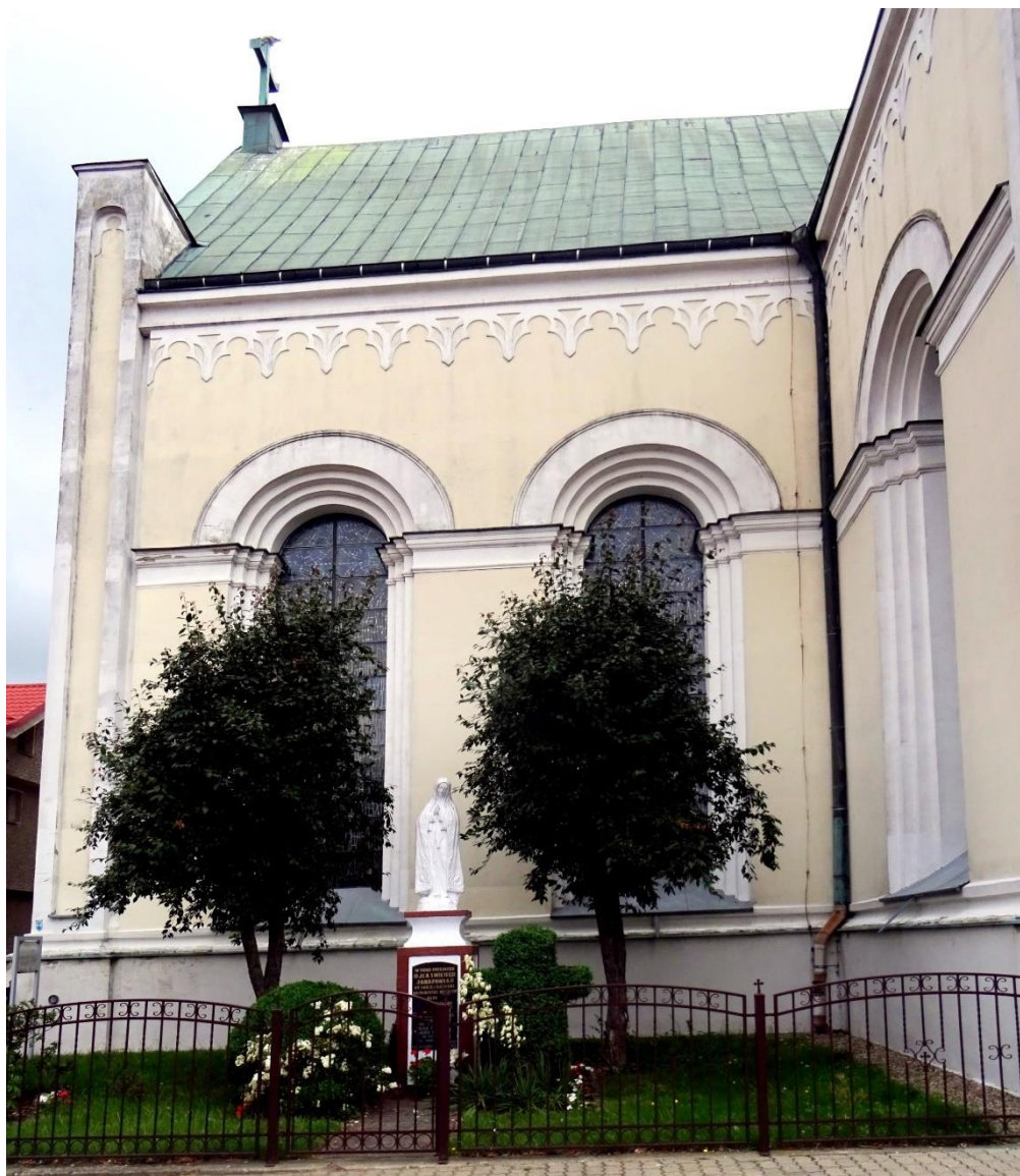
45. Na zdjęciu: dach z blachy miedzianej pokrytej zieloną patyną i figura Matki Bożej Fatimskiej ustawiona w 1979 r. dla upamiętnienia pierwszej wizyty w Polsce papieża Jana Pawła II (fot. Zb. Januszaniec, 2021 r.)
